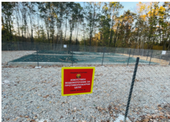
Снимка №3: Изкуствен водоизточник за противопожарни цели в отдел 1103. Автор: Д. Дамянов.
